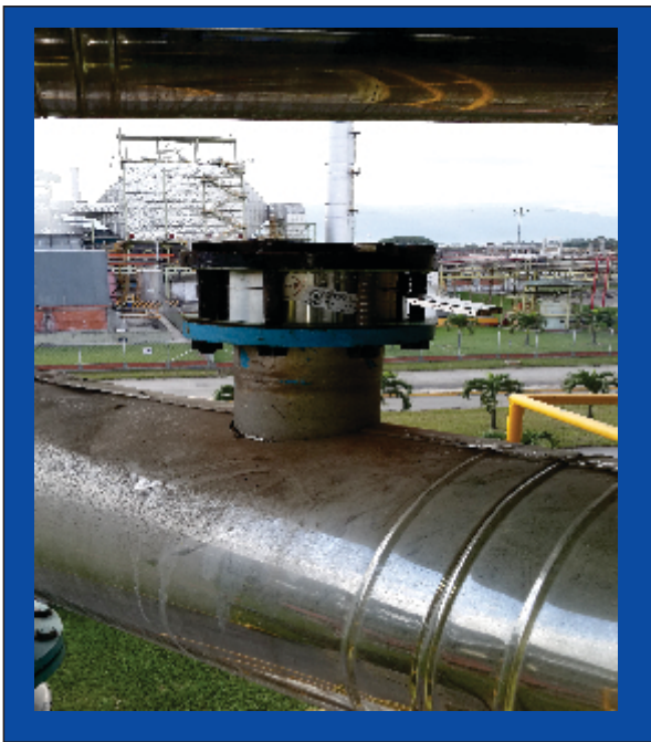
Discos de Ruptura instalados en los Tamices moleculares, de la Planta de alcohol en Ingenio Providencia ■
